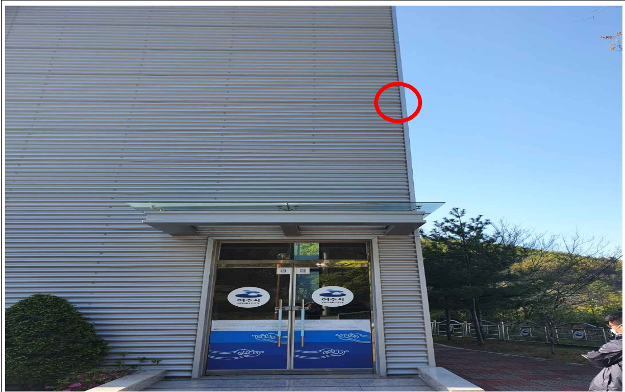
CCTV 출측 설치 개소
